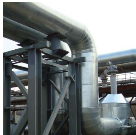
Системы вентиляции, кондиционирования и трубопроводы
